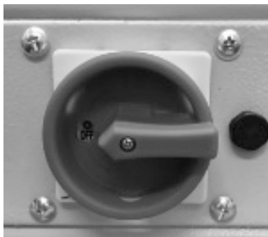
Abb. 3: Not-Halt = Hauptschalter, Outdoor, mit Wetterschutzkasten
